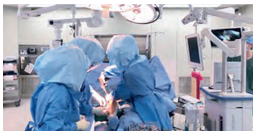
バイオクリーンルーム
