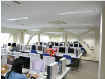
計算機室 ・脆弱な壁を撤去し、耐震ブレースを取付け、大型研究スペースを確保しました。
