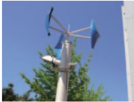
風力発電設備
