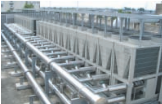
新しく導入された空調機(冷温水用熱源)
