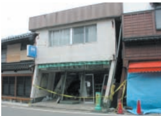
商店建築の被害(間口一杯が開口部のため強度が弱くなっている)
