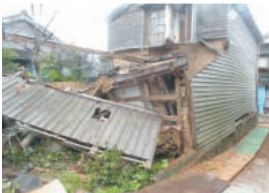
下屋部分の破壊(構造強度が不足している)
