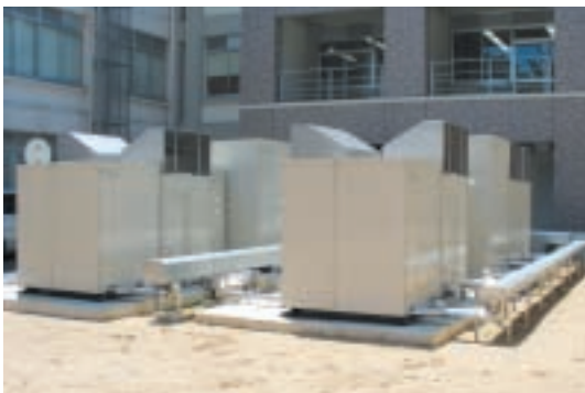
工学部1号館に設置の氷蓄熱空調システム
