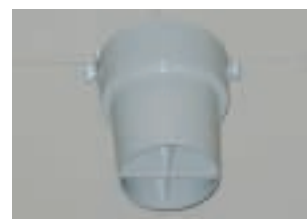
天井面に設置したサーキュレーター
