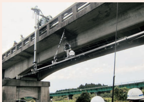
橋梁点検システムロボット「視る診る」
