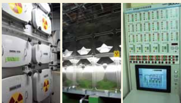
図1 排気設備 図2 貯蔵タンク 図3 放射線中央監視装置
