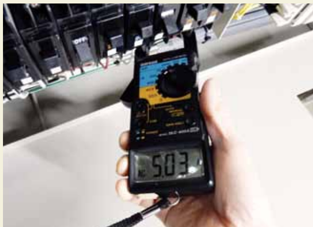
改修前の電流値5A 電圧200Vなので消費電力1000W
