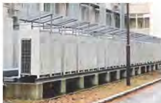
▲文京キャンパスのヒートポンプ・蓄熱システム
